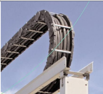
Гусеничный короб на колонне
